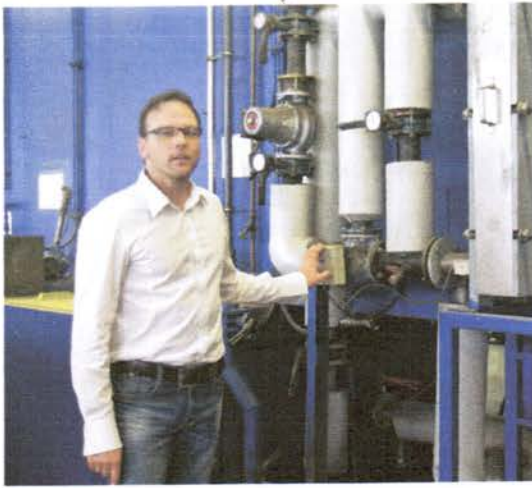
Das Blockheizkraftwerk (links) leistet genau das, was es soll – Heiko Wandel ist mit diesem neuen Mitarbeiter seines Unternehmens rundum zufrieden. Oben: Die Produktionsanlagen bei Wandel sind ausgesprochen energieintensiv.
